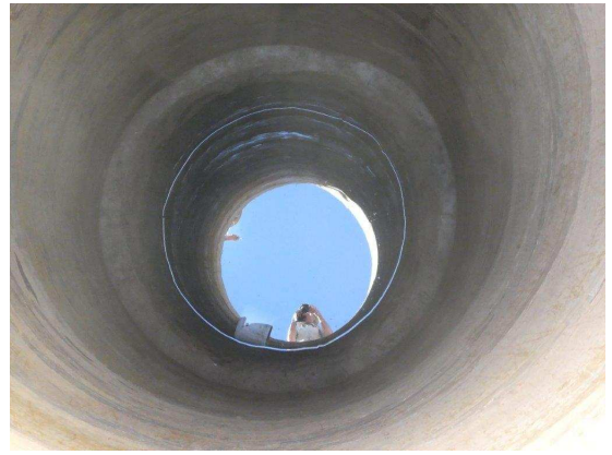
L'eau apparaît à 11 mètres
